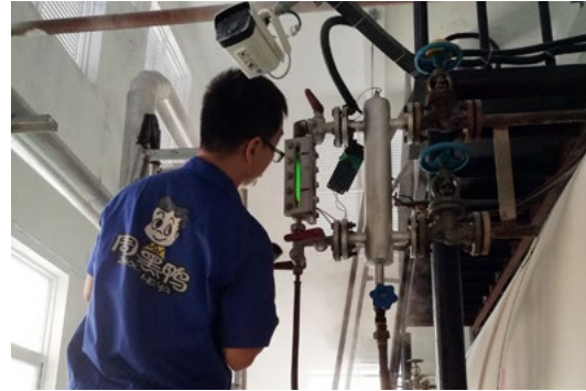
鍋爐缺水事故演練
